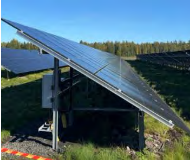
Kuva 8. Omien perustusten varaan asennettuja aurinkopaneeleita (Sitema Oy)
